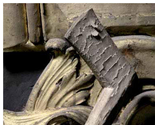
Xyan är tillverkad av trä som målats med limfärg. Färgskiktet flagar kraftigt.
