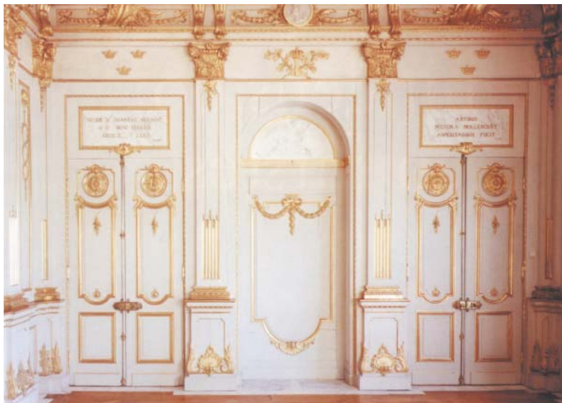
Bibliotekets södra vägg. Lägg märke till ett antal smala sprickor i snickerierna. De stör inte rummets helhet utan visar att vi har ett levande material, trä, som påverkas av rummets klimat.
