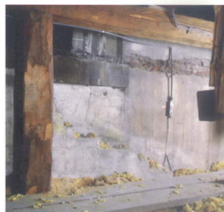
Gul puts fick slottet inte förrän 1754. En del av den västra fasaden kom att täckas in då den nordvästra flygeln byggdes, och kan ses på denna flygels vind. Fasaden är smutsad, och oljefärgen på sandstenen är dessutom starkt mörknad efter sekler utan ljus. Analyser visar att också denna var ljus gul.
