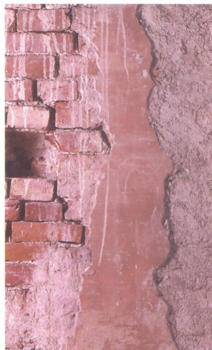
Tessins ursprungliga puts, vilken bevarats inne på slottets vindar. Putsen är mycket slät och avfärgad med ljus tegelröd kalkfärg, horisontellt utstruken. Ytan har under ett par decennier, innan den byggdes för, utsatts för väder och vind och är något smutsad.
