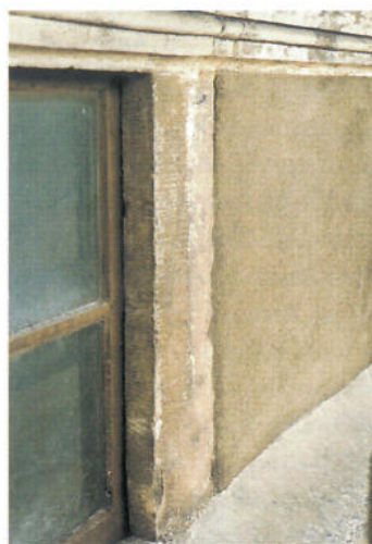
Spår av rosa oljefärg på en av Norra längans fönsteromfattningar.
