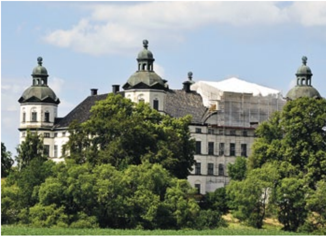
De svartglaserade takpannorna ligger på öppen läkt. Under plasten arbetar Mattias med livlina med reparation av nockåsen.
